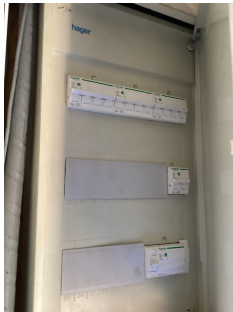
( Elektrisch bord - binnenkant )
