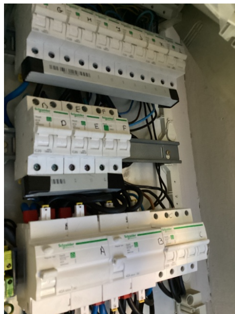
( Elektrisch bord - binnenkant )
