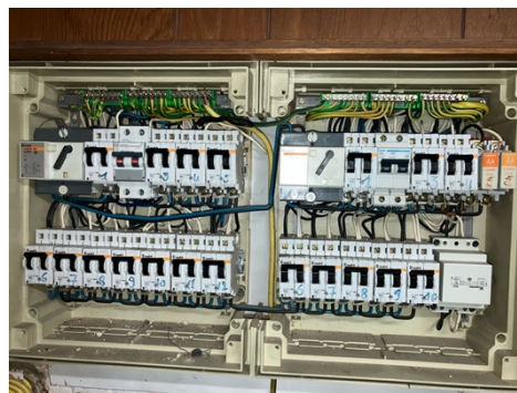
(Elektrisch bord - binnenkant)
