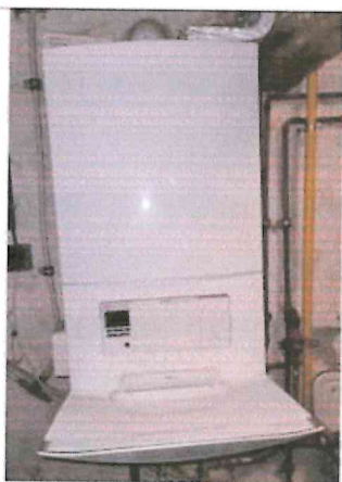
Chaudière Gaz naturel à condensation (Chauffage et ECS)
